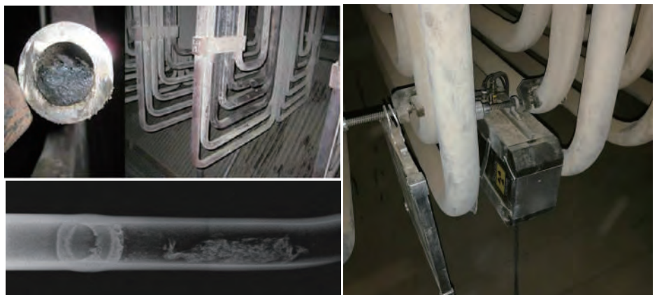
发电厂设备配管检测案例
